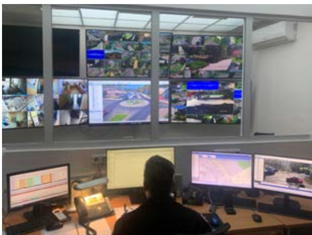
↑ Nové dohledové centrum Městské policie Bílina – prostor pro operátorku MKDS a operačního pracovníka/strážníka MP
